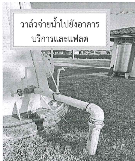
รูปภาพแสดงวาล์วที่ใช้เปิด-ปิดจ่ายน้ำไปยังอาคารบริการและแฟลตบ้านพัก
