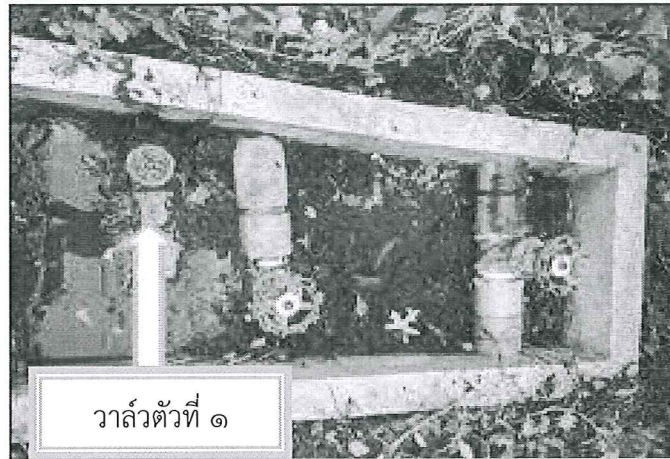
รูปภาพแสดงวาล์วสำหรับ Bypass น้ำประปา
